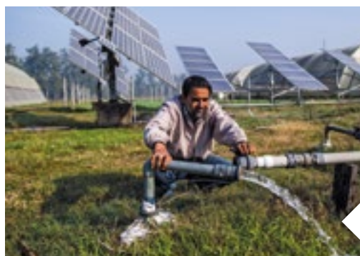
Pompage d'eau souterraine avec l'énergie générée par des panneaux solaires, à Jagadhri en Inde.
