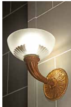
➤ Une lampe parmi d'autres, dans le hall d'entrée principal
